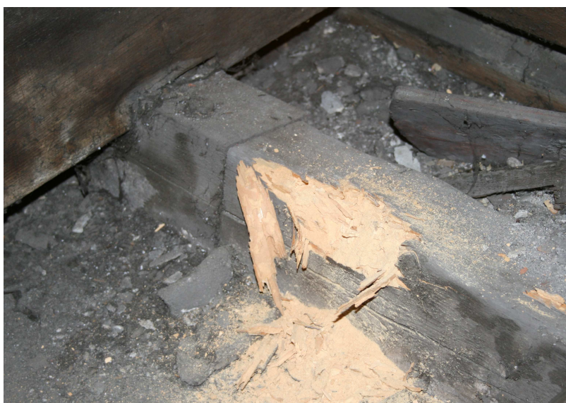
Fot. nr 5 Zniszczona przez owady i korozję biologiczną murlata
