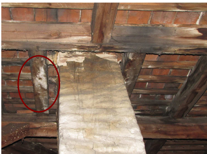
Fot. nr 6 Znaczne zacieki na kominie, wskazują na nieszczelności w pokryciu dachowym. Na wskutek czego dochodzi do zawilgocone i zagrzybione belek konstrukcji więźby dachowej
