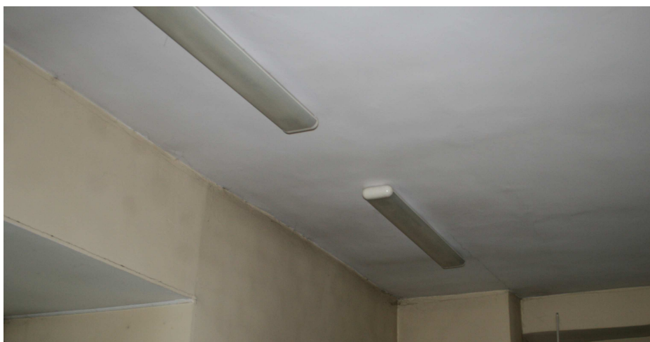
Fot. nr 2 Widoczne przemarzanie na suficie (efekt zbyt małej grubości ocieplenia na stropie i nieszczelności w pokryciu dachowym) oraz na ścianach (nieocieplana powierzchnia dachu w mansardzie dolnej) sala 236
